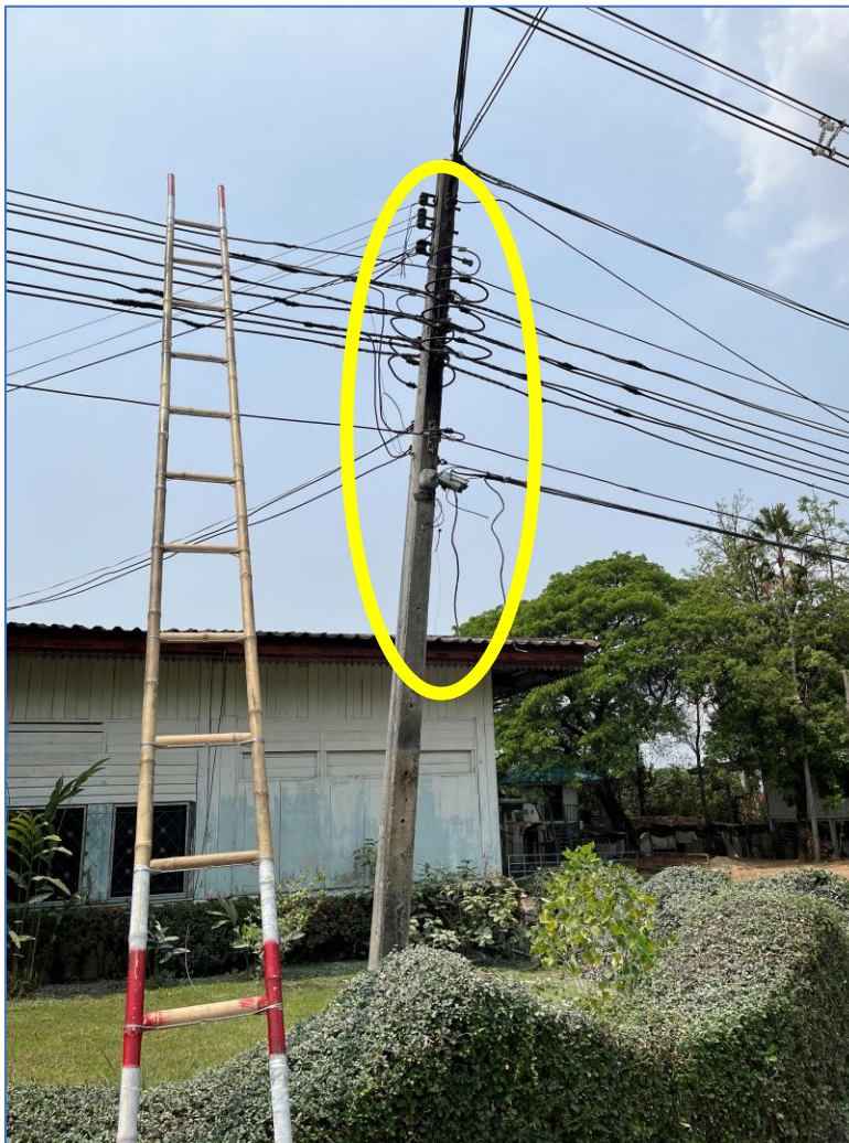
บริเวณที่เกิดเพลิงไหม้ มีแนวสายใยแก้วนำแสงใหม่ขาดชำรุด
