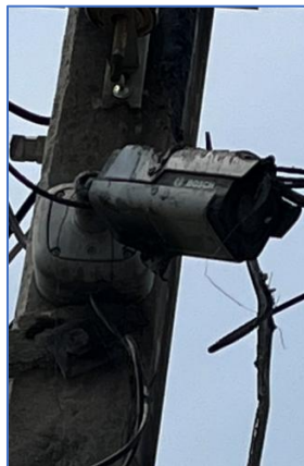
ภาพกล่องวงจรปิดที่เสียหายจากเพลิงไหม้
