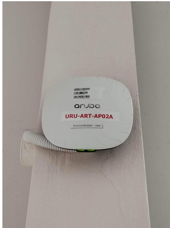
ภาพการสำรวจการใช้งานได้ของอุปกรณ์ Access Point
