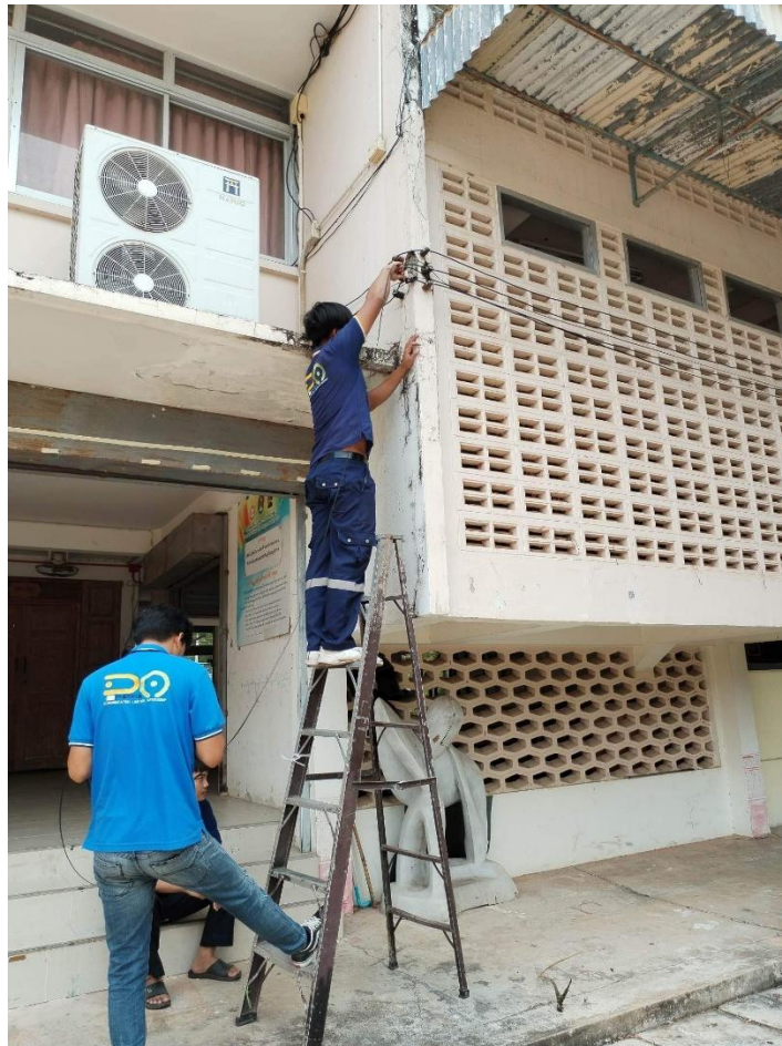
ภาพการเดินสายสัญญาณใยแก้วนำแสงใหม่ จำนวน 2 เส้นทาง
